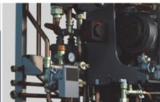
Pompes de circuits de chauffage
